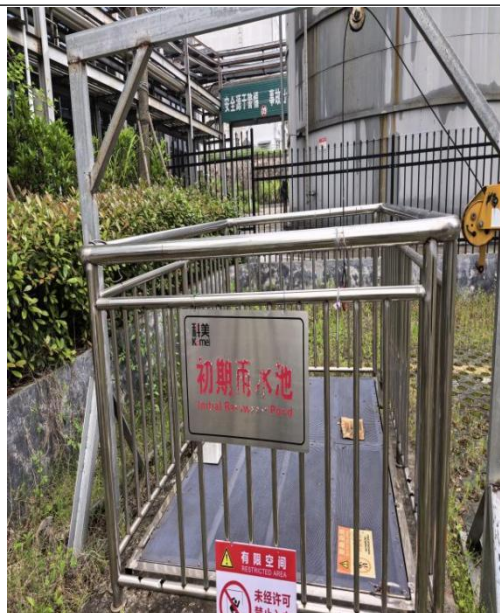
设有初期雨水池
