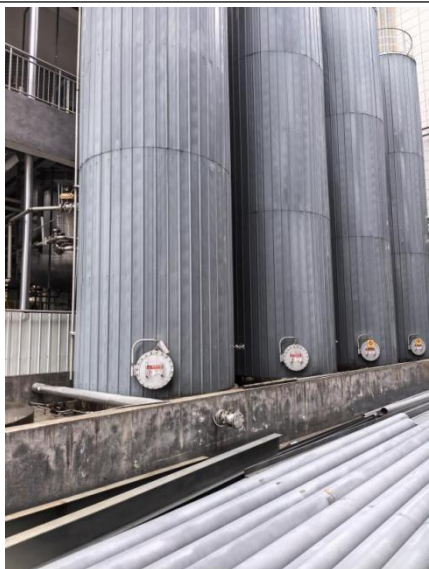
生产装置区防泄漏围堰
